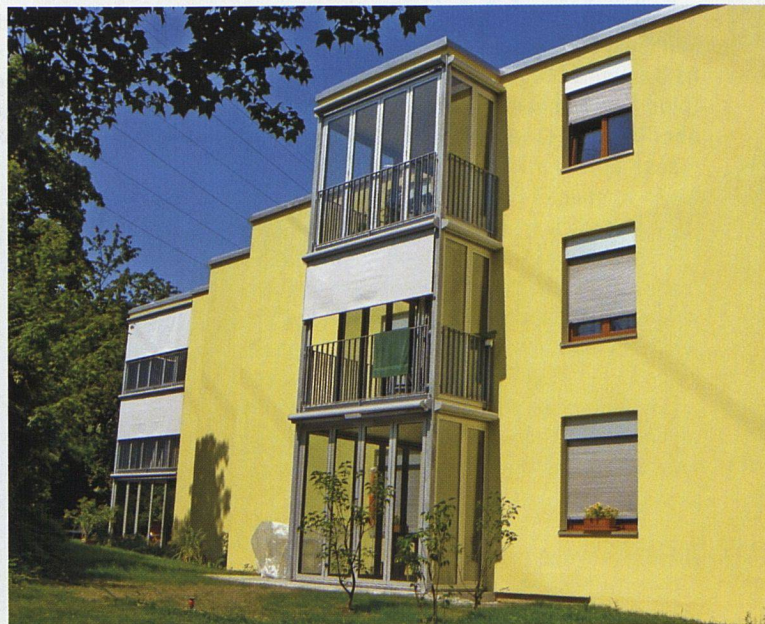
Wegen den direkt an die Fassade angrenzenden Fenstern war eine zusätzliche Isolationsschicht nicht möglich.
