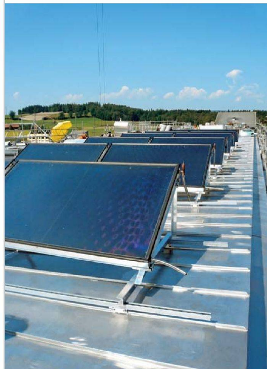
Die Solaranlage umfasst 120 Flachkollektoren.
