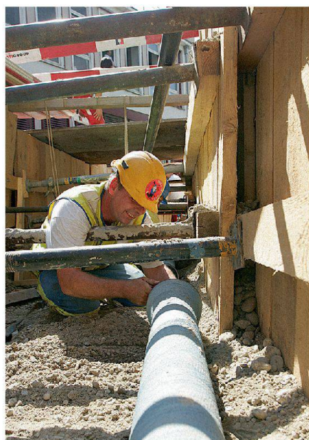
Wasserleitungen im Boden werden ab siebzig Jahren ersetzt, in Häusern ab etwa dreissig Jahren.
