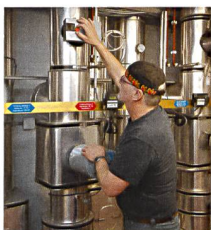
Titelbild: Ein ABZ-Hauswart wartet die Fernheizung der Siedlung Jasminweg. Was Hauswarte sonst noch leisten, zeigt eine aktuelle Studie.
