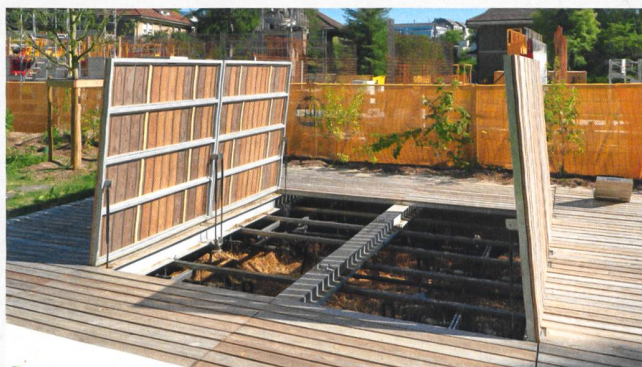
Im Garten befindet sich die siedlungseigene Kläranlage. Regenwürmer sorgen hier für die Endreinigung.
