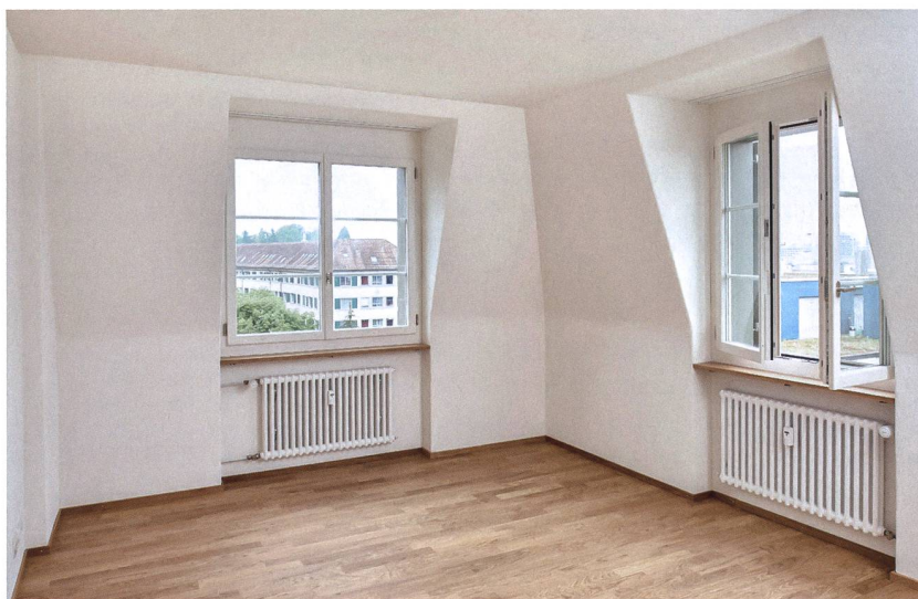
Saniertes Zimmer im Dachgeschoss. Die Böden und die Decken in den Häusern sind neu gedämmt und bieten besseren Schallschutz als früher, allerdings nicht auf Neubaulniveau.
