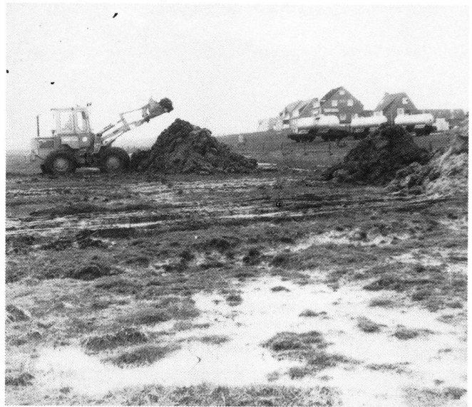
Der durch behördlichen KFZ-Verkehr ruinierte Deichfuß wird repariert. Große Hellerflächen gehen dabei zugrunde.
