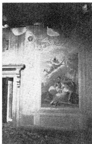
Villa Valmarana: beschädigte Fresken von Tiepolo
