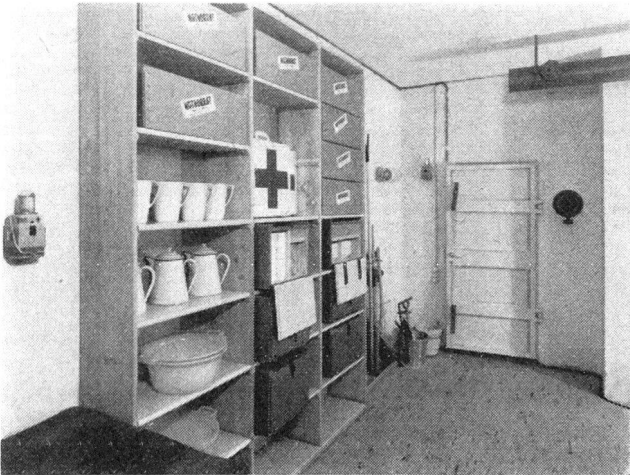
«Küche» mit Essgeschirrkisten und einem Teil des Notvorrates. Rechts oben ein Zuluftrohr, darunter das der Abluft dienende Ueberdruckventil.
