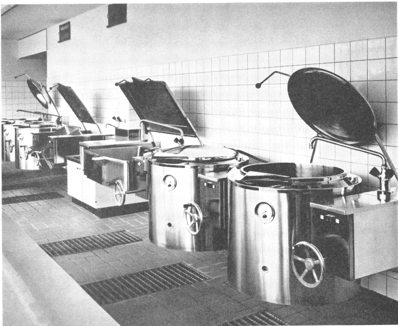
Ausschnitt Kücheneinrichtung Militärkantonnemente Sarnen. Planung, Fabrikation und Lieferung SALVIS
