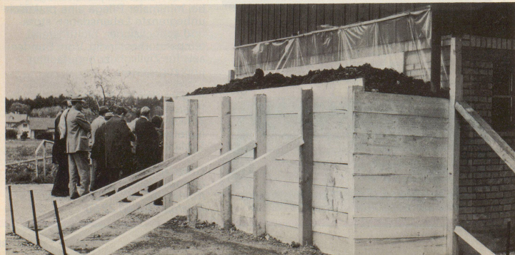
Ein weiteres Beispiel der Verstärkung des Schutzes durch einen mit Brettern eingefassten Erdwall
