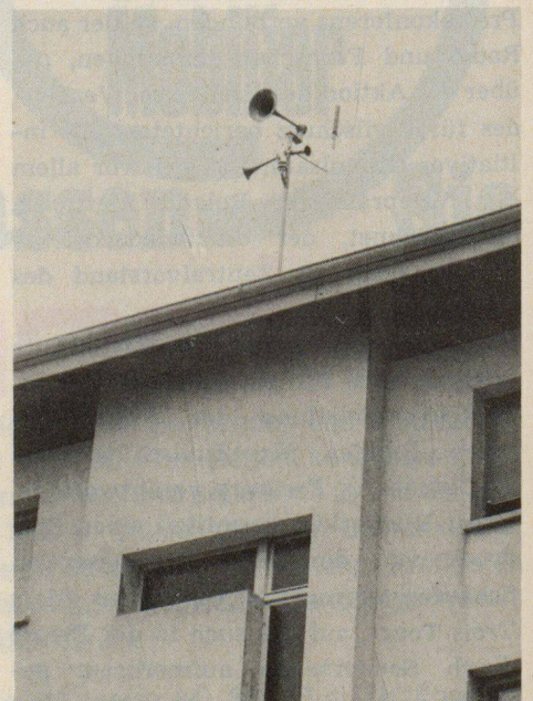
Sirenenstandort chemin du Milieu in Martigny
