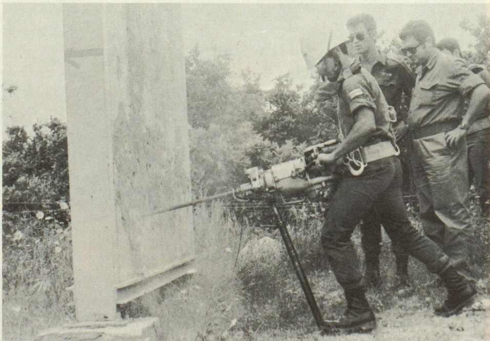
Instruction au marteau de démolition. Les centres d'instruction de la protection civile de la HAGA rassemblent beaucoup à ceux de la Suisse
