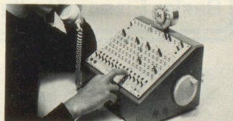
Zentrale mit zwei Amtsanschlüssen.
