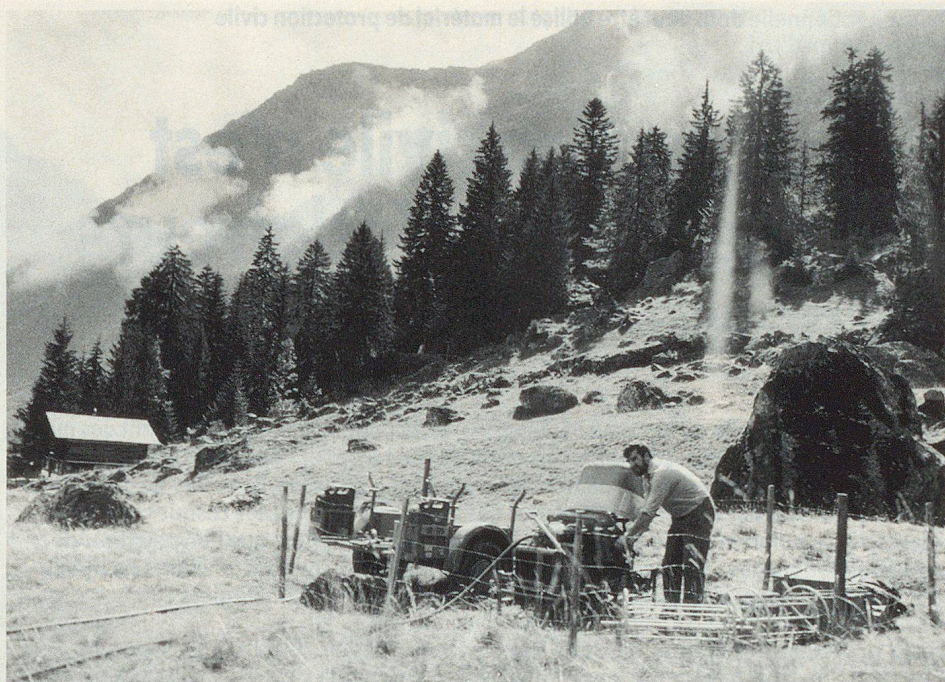
Der Erstfelder Ortschef Paul Jans inspiziert auf den Bodenbergen einen Kompressor, der zuvor mit einem Helikopter auf fast 1500 Meter über Meer hinaufgeflogen wurde.
