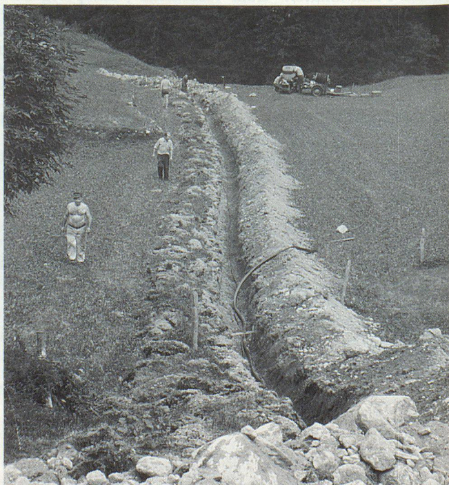
Endlich genügend und besseres Wasser dank einer in den Boden verlegten Wasserleitung.
