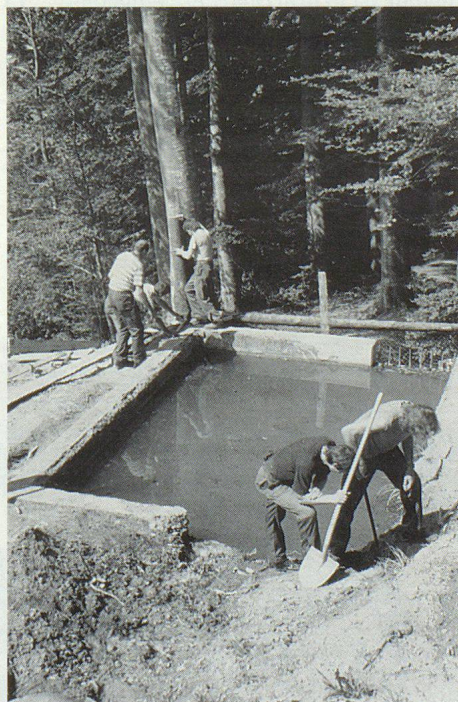
Am Greulenbach oberhalb des Riedlis wird ein Schlammssammler eingezäunt.
