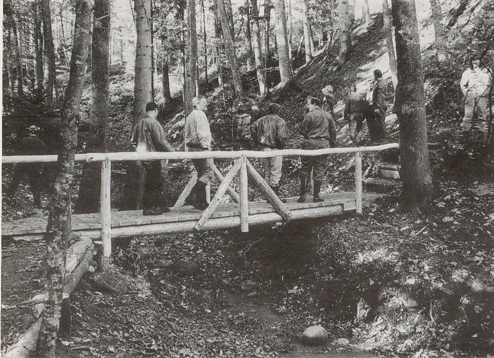
Bei der viertägigen Übung wurden im Zuge von Wanderwegausbesserungen und -anpassungen auch Brücken ersetzt oder repariert.
