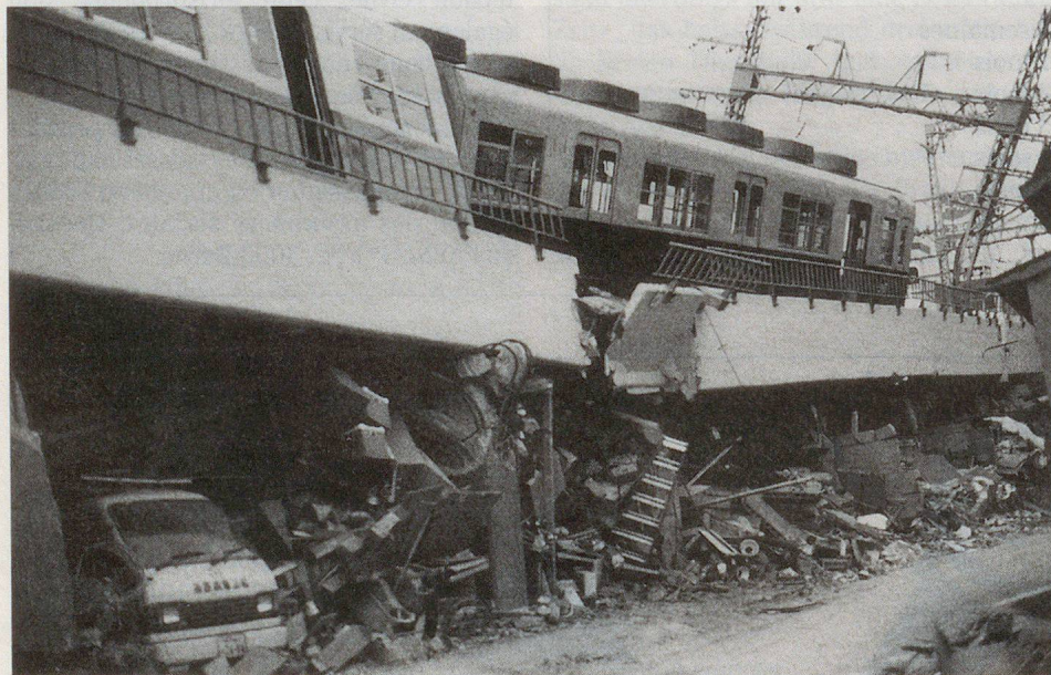
Voies de communication détruites.
