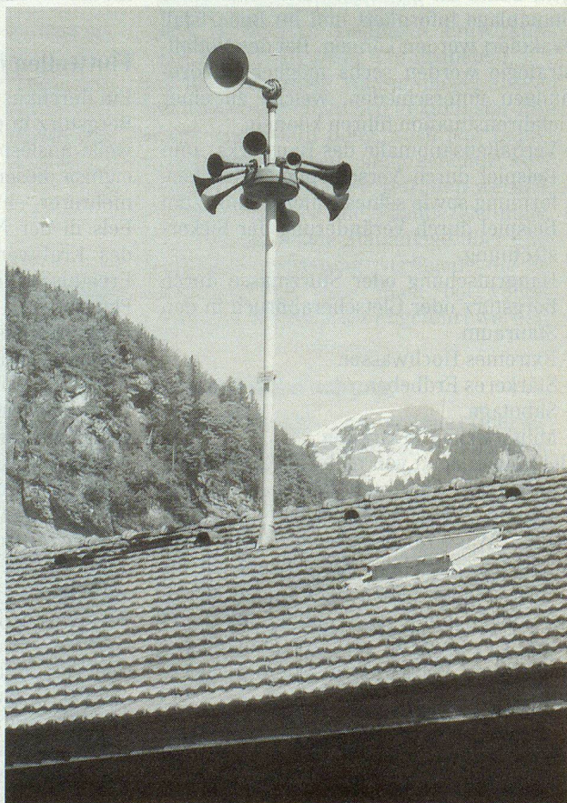
Meiringen: Wasseralarm- und Feueralarmsirenen auf einem Dach.
