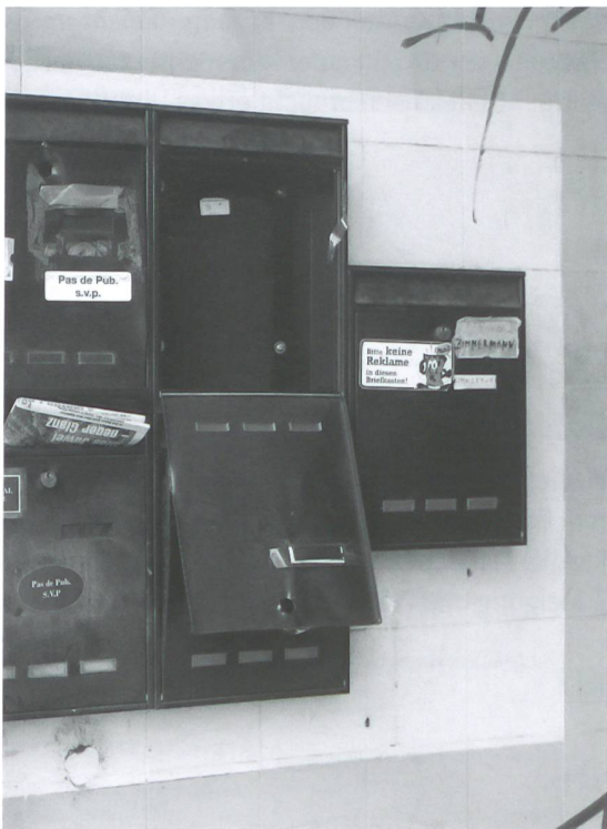
Veraltet und in schlechtem Zustand: Wohnraum in Biel.
