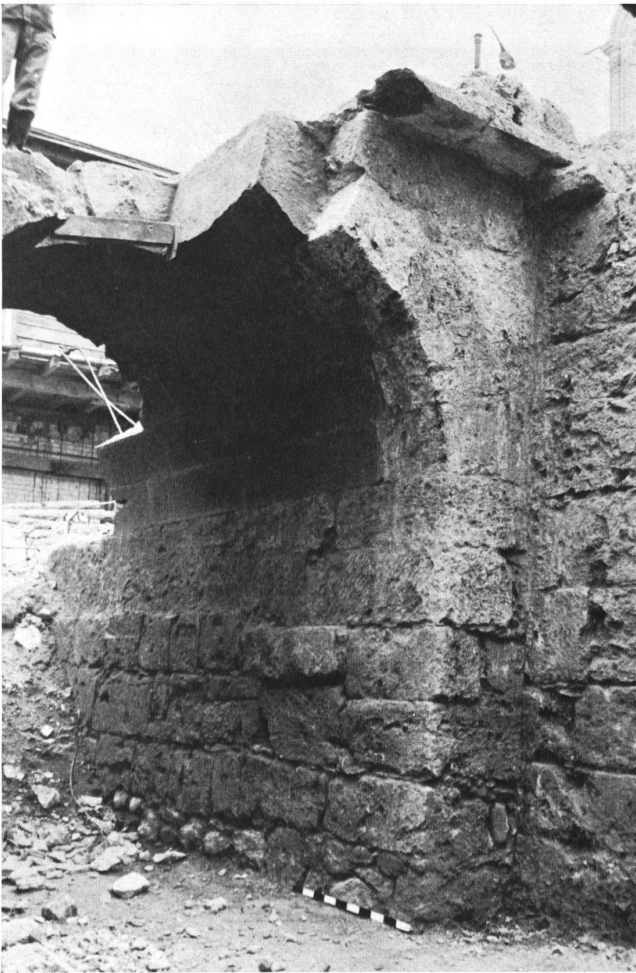
Abb.9: Grabenbrücke, östliches Widerlager. Unten Vormauerung 3 e, darüber der Bogen des ersten Brückensjochs. Deutlich erkennbar sind die vorkragenden Ringgenberger Platten mit den Fragmenten der Brüstung, darin das Ablaufloch.
