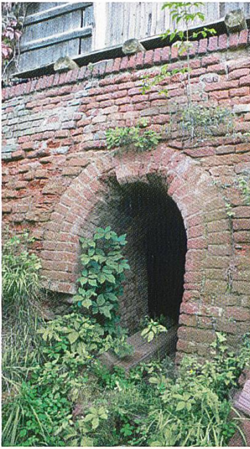
Leoben in der Obersteiermark A, ehemalige Ziegelei Dörfler: östlicher Eingang in den Ringofen.
