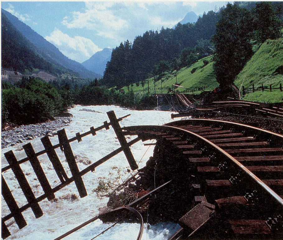
Am 23./24. August 1992 führte anhaltender starker Regen zu Überschwemmungen im Kanton Uri. Dabei unterspülte die Reuss die Gotthardbahnlinie.
