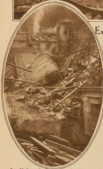
Beim Neubau in den Gartenanlagen der Villa Sumatra in Zürich ereignete sich Freitag früh ein großer Mauersturz, der, wenn er während der Arbeitszeit erfolgt wäre, wohl ein schweres Unglück zur Folge gehabt hätte
