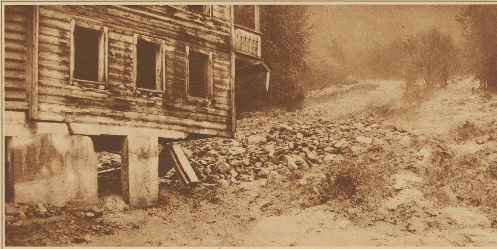
Die Verheerungen des Sundbaches bei Sundlauenen am Thunersee. Das Haus wurde vollständig unterspült. Kaum war es fertig geräumt, stürzte es ein (Phot. Bonafini)
