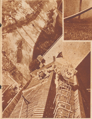
Dachdecker beim Aufstieg zur Kirchenspitze. Der Reparatur, dem wir diese Aufnahme verdanken, muß sich unbedingt mit'muten werden - er hant auch Mut.
