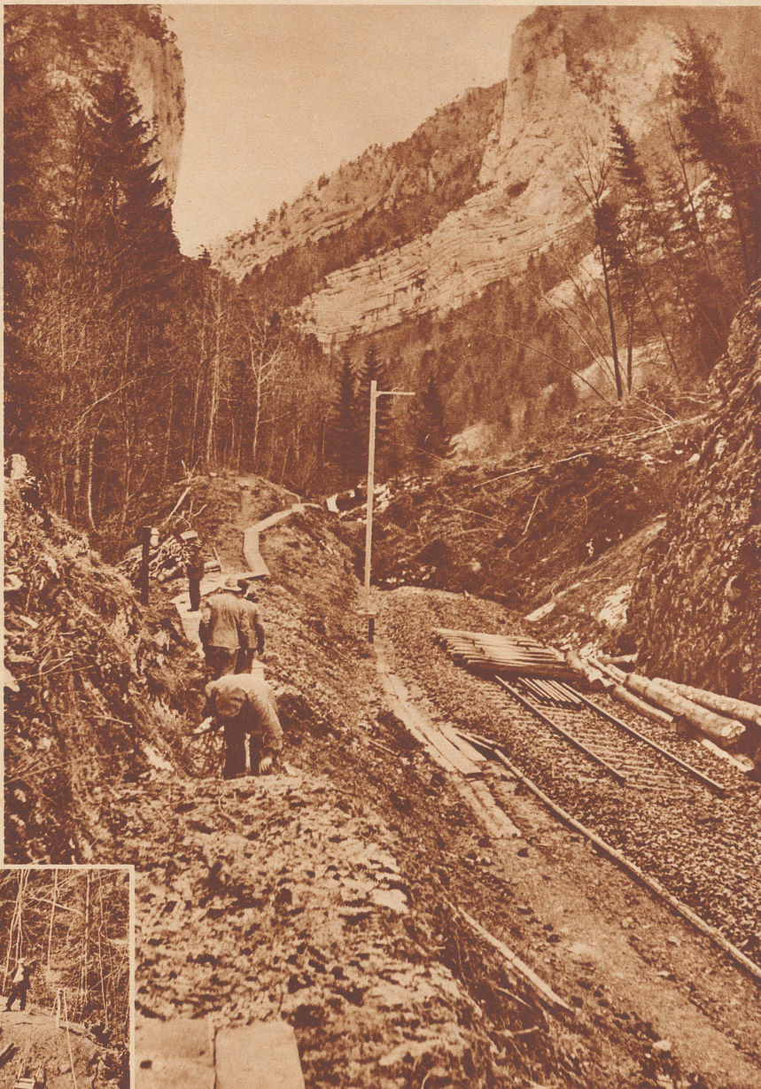
Blick in die enge Klus von Court mit einem Teil der Verheerungen des Erdrutsches. Auf eine Länge von 300 Meter ist das Bahntrasse mit mächtigen Felsblöcken, Schutt und Bäumen meterhoch verschüttet. Wo das noch möglich war, wurde in aller Eile das Geleise abmontiert.
