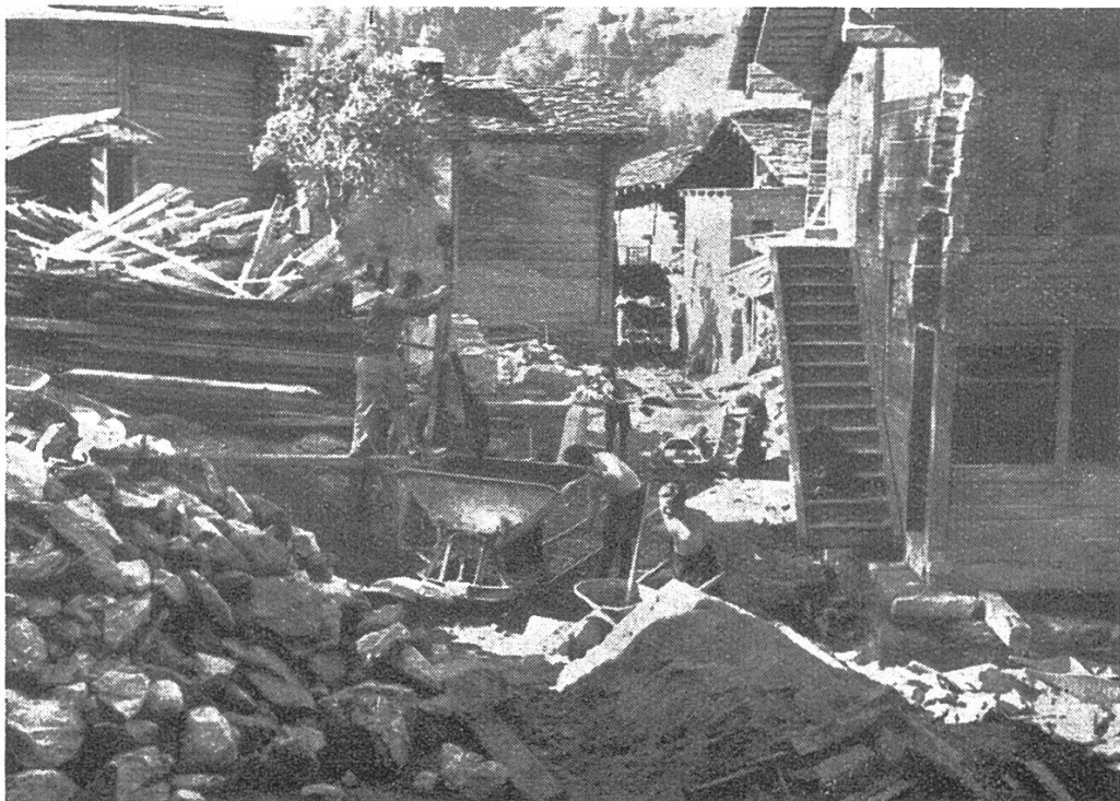
Aufräumarbeiten in Lourtier
